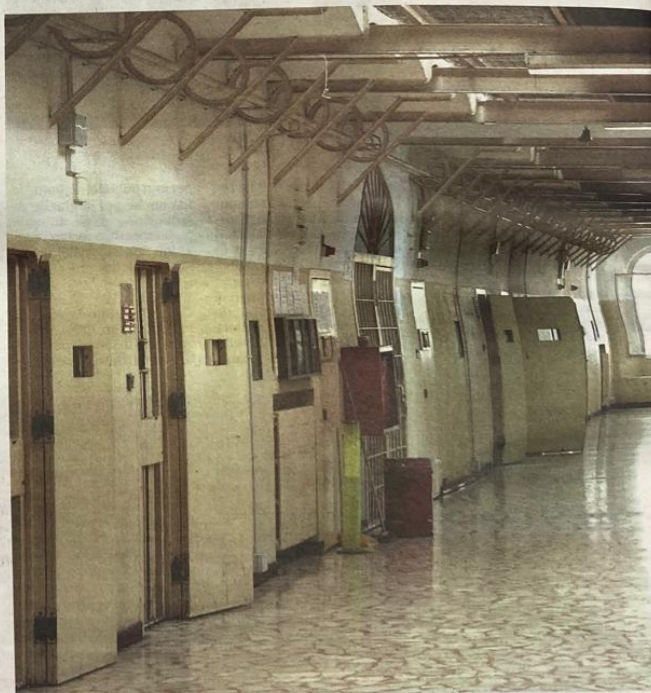
In via Poma Un'interno del carcere dove sono stati installati maxi ventilatori nelle celle
